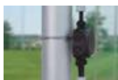
Управление освещением спортивной площадки
