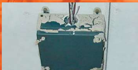
Ответвительные коробки с подключенными кабелями после теста
