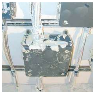
Ответвительная коробка с подключенными кабелями после испытаний.
